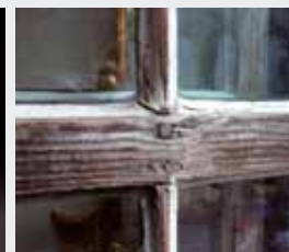
Die Glaskittungen der barocken Fenster sind brüchig und die Fenster abgewittert The luting of the baroque windows is brittle and the windows are weathered
