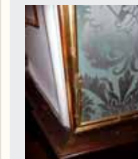
Gebrochener Holzrahmen einer Wandbespannung Broken wooden frame of wall coverings
