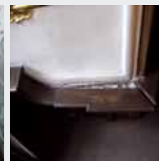
Durch die Verformungen im Bereich der Lambris sind große Fugen zum Mauerwerk entstanden Through deformation in the region of the wainscot, big gaps formed
