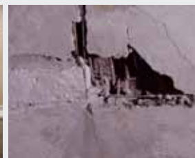
Massive Risse im Bereich der Stuckdecke Massive cracks in the stucco ceiling
