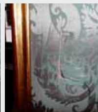
Zerrissene Wandbespannung Torn wall coverings
